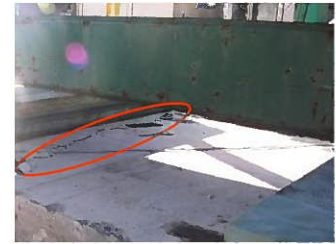
写真-2 破壊状況
