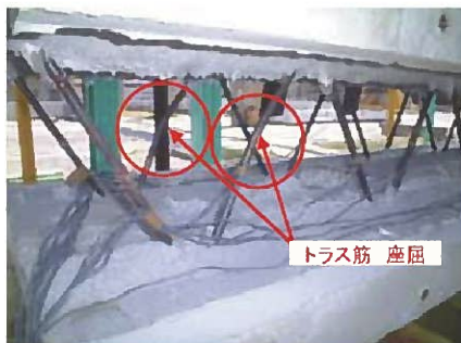
写真-13 破壊状況
