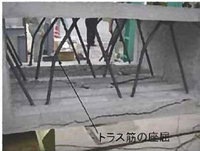
写真-15 破壊状況
