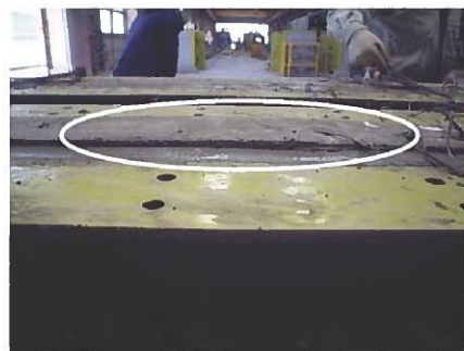
写真-6 打設中のEPSの浮き上がり
